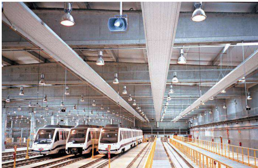
Instalación de calefacción con paneles radiantes SABIANA en el metro de Madrid.
