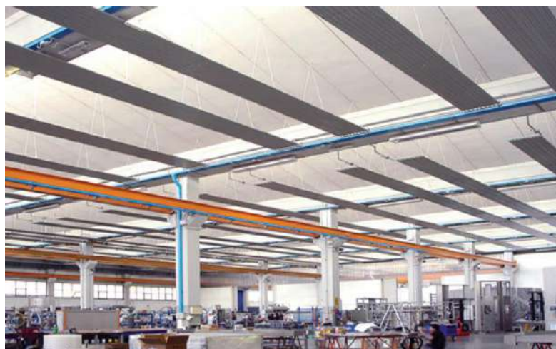
Instalación en fábrica con panel radiante SABIANA: Sin ruido, sin movimiento de aire y con temperatura uniforme en todo el espacio.
